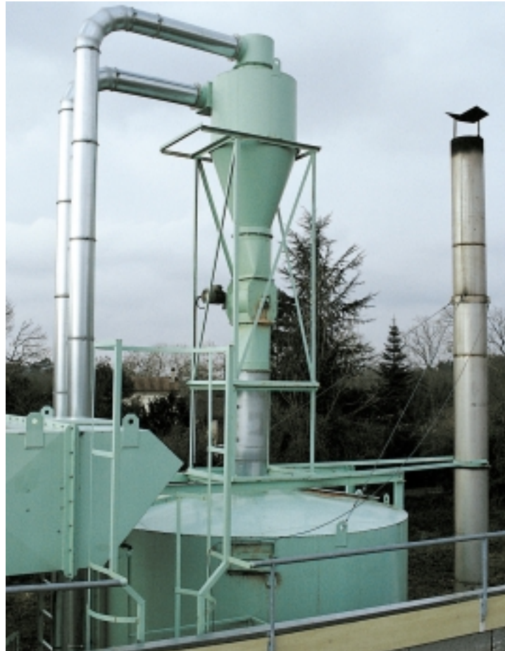
Un broyeur à déchets couplé à une chaudière pour le brûlage des copeaux de bois équipe désormais l'atelier. Cet investissement supplémentaire a permis des gains de temps au niveau de l'entretien et simplifié la gestion des déchets.
