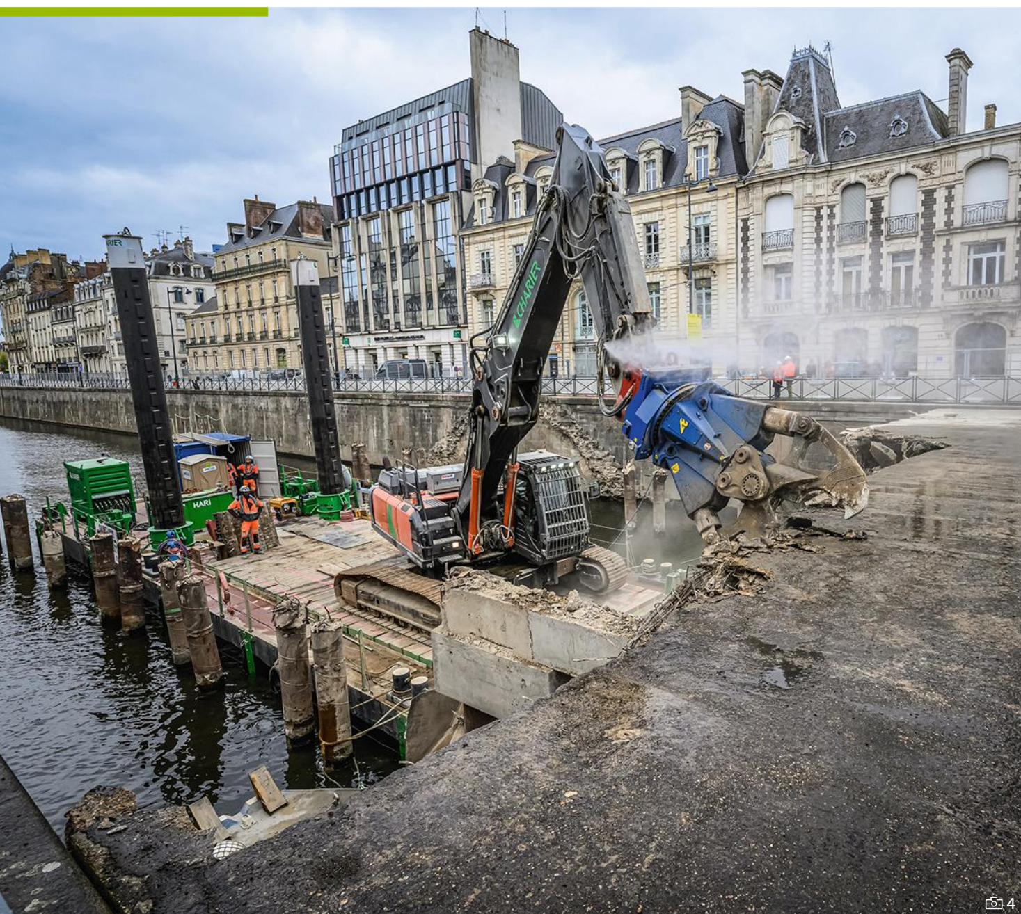
❏ 4. LES DÉBLAIS ABATTUS représentent en moyenne cinq rotations journalières de barges chargées des gravats à évacuer. Pendant l'intervention de la pelle, les trois membres de l'équipe restent en retrait, prêts à intervenir en cas de besoin. La brumisation limite l'émission de poussières.
